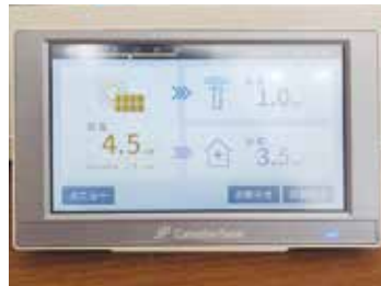
△ 発電モニター
